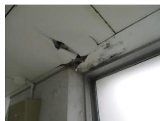
天井雨漏り・内装の劣化
