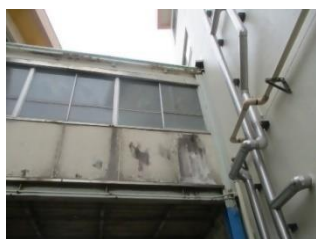
外壁塗装の剥れ
