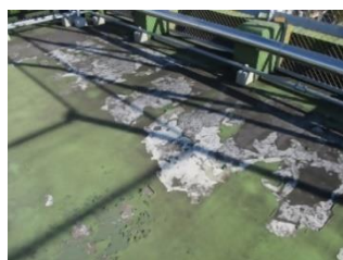
屋上防水の剥れ
